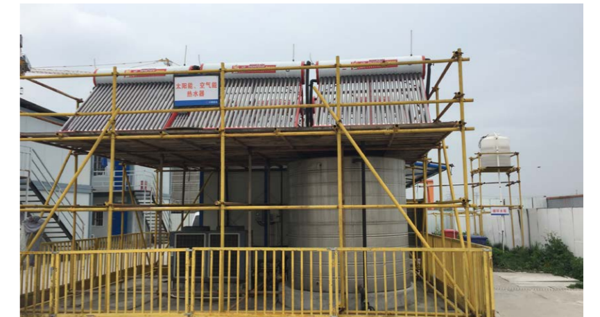
上海玲珑悦府项目·太阳能/空气能热水器
